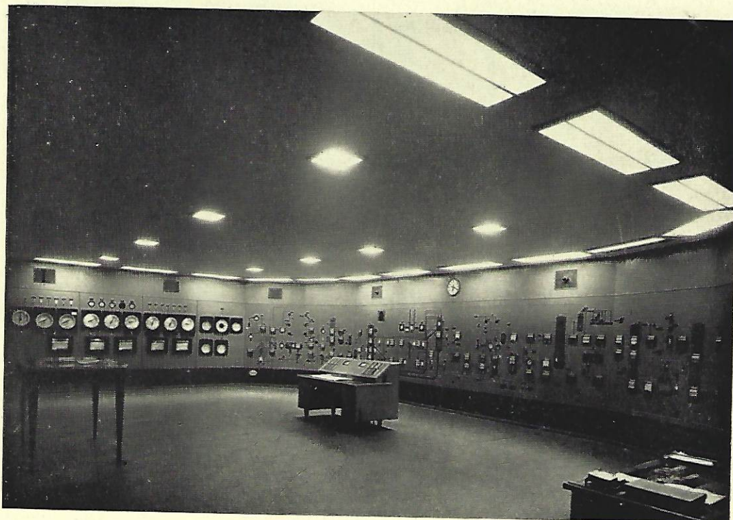
LA SALA DEGLI STRUMENTI DI CONTROLLO DI UNA UNITA' DI LAVORAZIONE SELETTIVA
